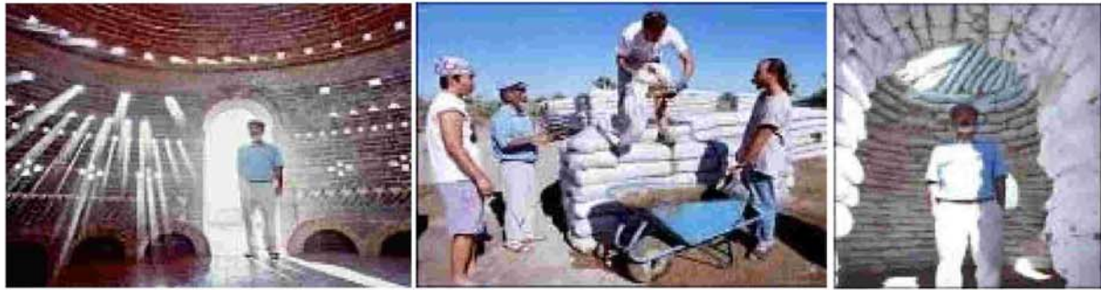
صورة رقم (1/3) المعماري نادر خليلي وإستخدام المواد البيئية في العمارة والبناء -المصدر: " (2000) : Yasha Hessian Space-Friendly Architecture: Meet Nader Khalili " ,www.space.com (Accessed8/8/2004)
